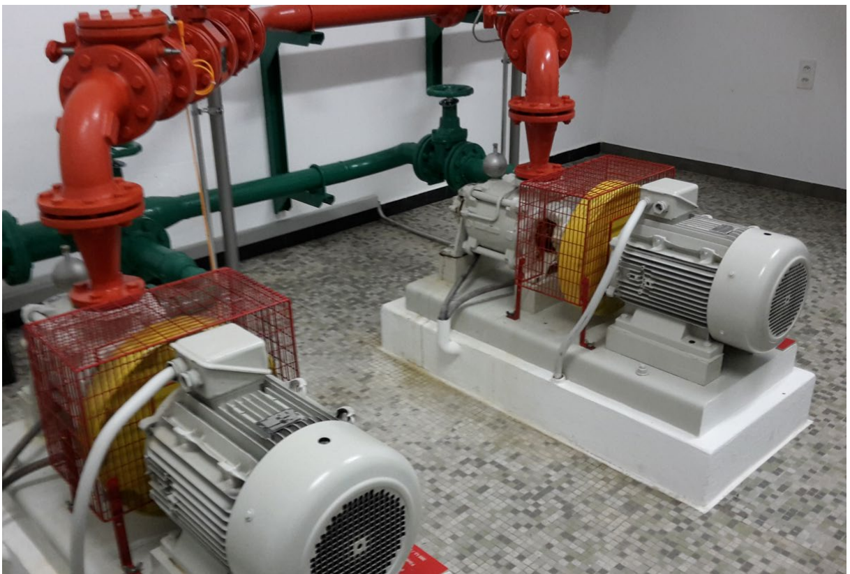
Stufenpumpwerk Pool mit Verrohrung im Maschinenkeller
