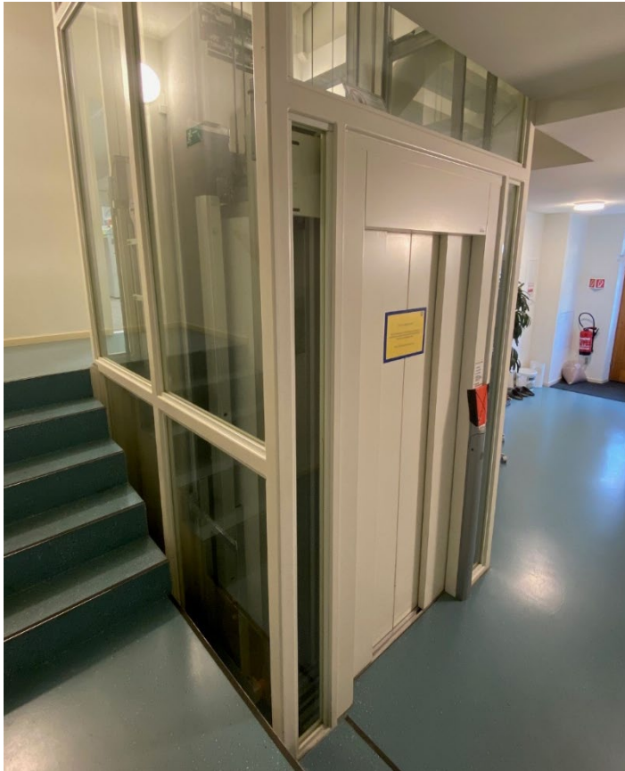
Liftanlage, welche ersetzt werden muss
