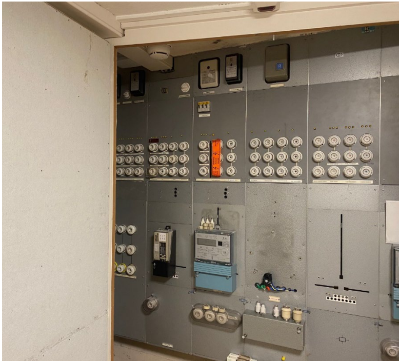
Hauptverteilung mit Schraubensicherungen und asbesthaltiger Blende und Türverkleidung
