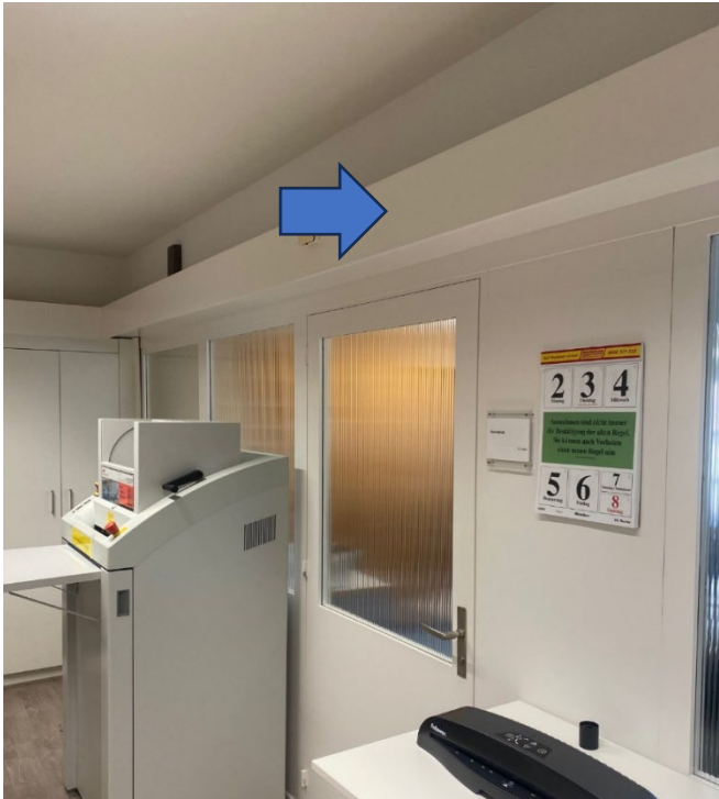
Kopierraum mit asbesthaltiger Brandschutzblende
